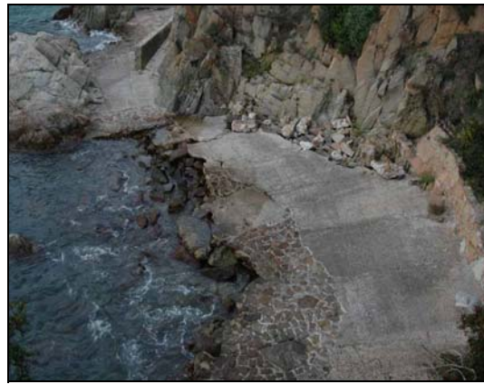
Plataforma de ciment en mal estat de conservació a Cala Trons. En la fotografia es pot observar l'esllavissada parcial del mur de contenció.
