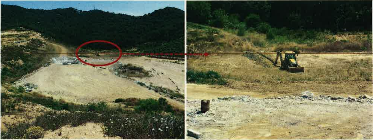
FOTOS 12 i 13: Realització d'una rasa per la reparació de la canonada de lixiviats que comunica el pou 2 al pou 3 del dipòsit controlat.
