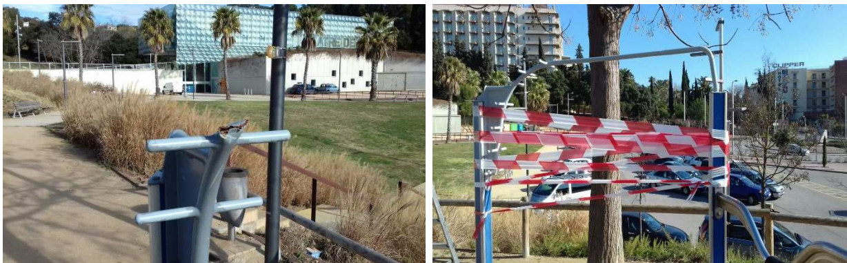
FOTOS 61 i 62: Element de salut trencat per uns desconeguts al parc de Can Xardó. Es programa la reparació corresponent al dany detectat.
